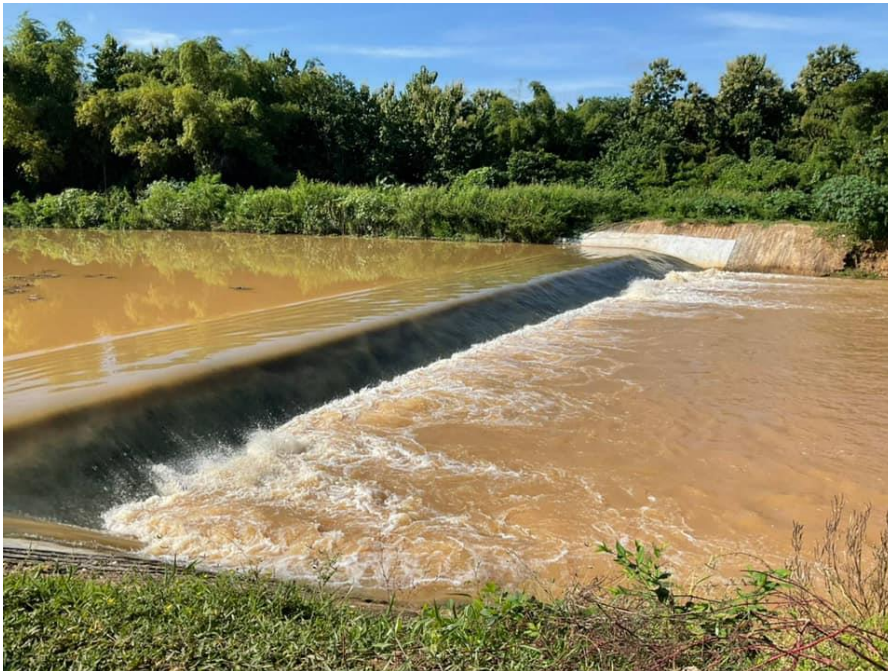
ภาพที่ 6 ฝายแกนดินซีเมนต์ที่ตำบลทุ่งชมพู อำเภอภูเวียง จังหวัดขอนแก่น
